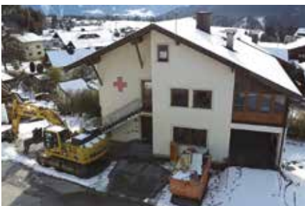
Die alte Wache am Achensee unmittelbar vor dem Abriss. © Rotes Kreuz Schwaz-Hochschwarzer
